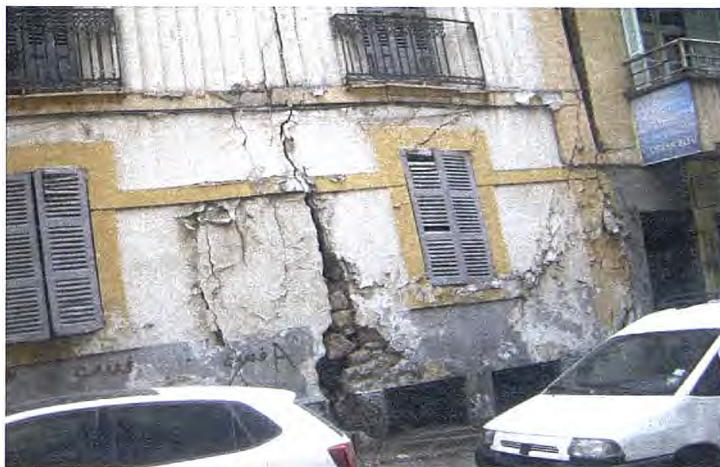
Rue Lemouissi : dislocation des murs porteurs et inclinaison de la construction occupée par les habitants (novembre 2011)
