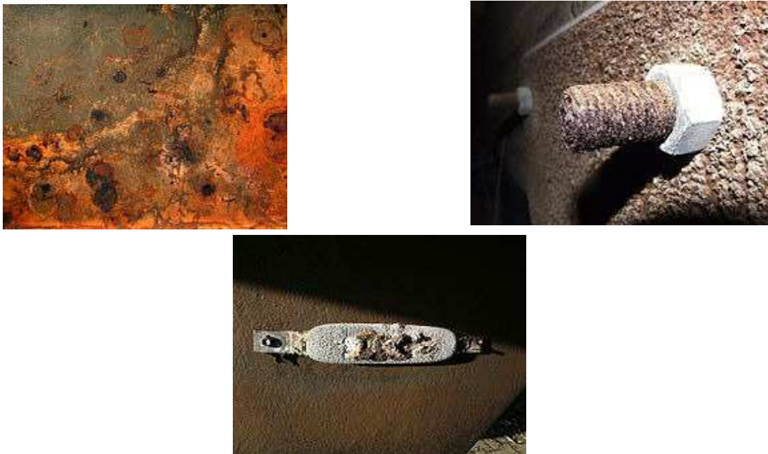
Figure 10. La rouille et la corrosion sur des métaux oxydables.
